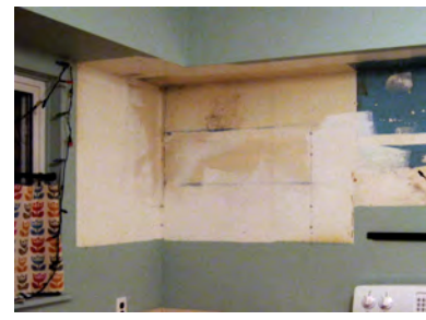
An Wänden hinter Möbelstücken, die an Außenwänden stehen oder hängen. Es fehlt hier oft eine ausreichende Luftzirkulation, die Feuchtigkeit aus der Wand aufnehmen könnte.
