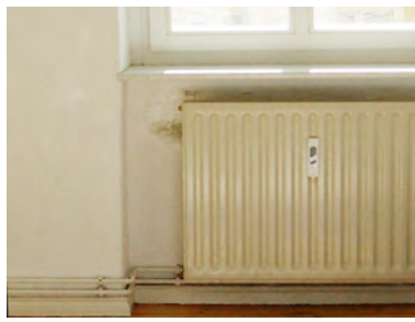
In Heizkörpernischen wenig beheizter Räume. Hinter den Heizkörpern sind die Mauern oft dünner als die übrigen Wandteile und die geringe Nutzung der Heizkörper fördert deren Auskühlung.
