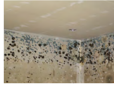
An der Unterseite von Tapeten und Wandverkleidungen
