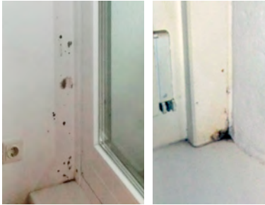
An Fensterstürzen aus Beton (besonders in Küche, Bad und Schlafzimmer)
