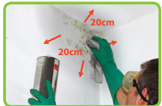
Schimmelstelle mit Spiritus durchtränken
